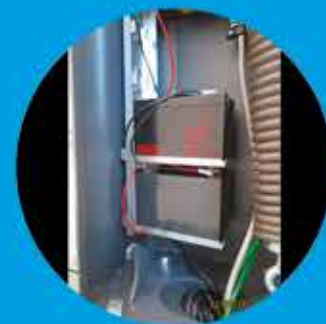
Batterie di emergenza
